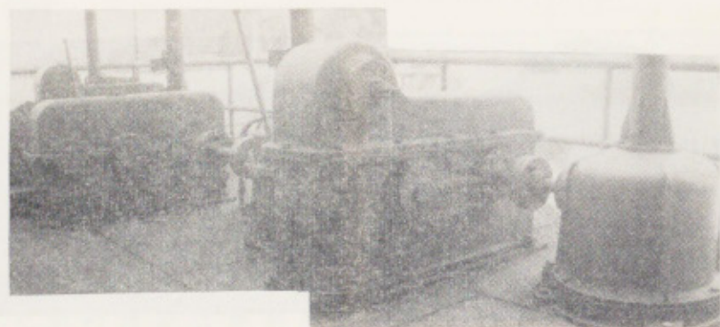
取入口上屋 現電化設備
