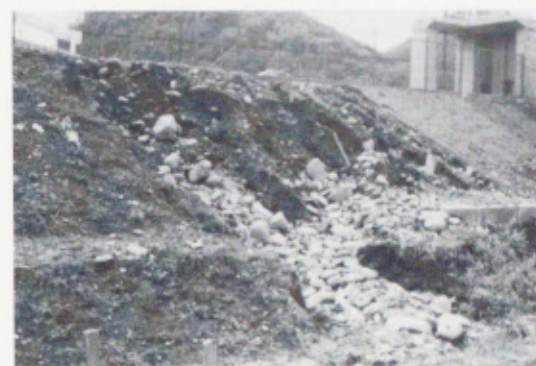
● 用水溝畔の法崩れ
