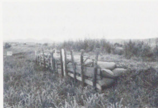
● 用水溝畔の法崩れ
