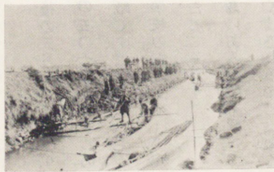
大正6年9月30日出水破壊工事場（長塚の西方503間）
