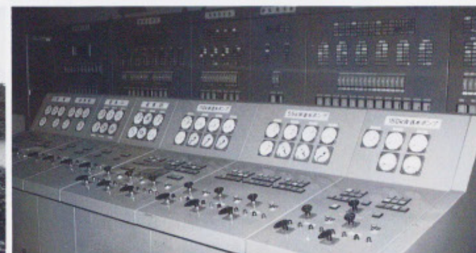
コントロール室のコンピューター
