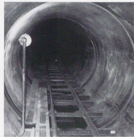
↑直径2.6mの下水管 下水は、この下水管を通して処理場に向かう。
