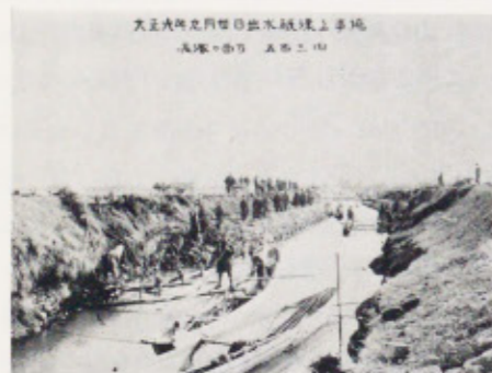
境川堤修築工事 大正6年9月 30日の大洪水で長塚地内の境川 堤が切れ河水が田畑に横流した
